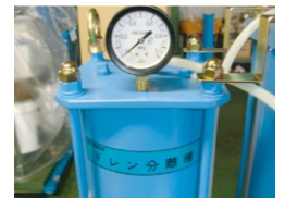
ドレン分離槽 圧力計
