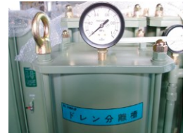
ドレン分離槽 圧力計
